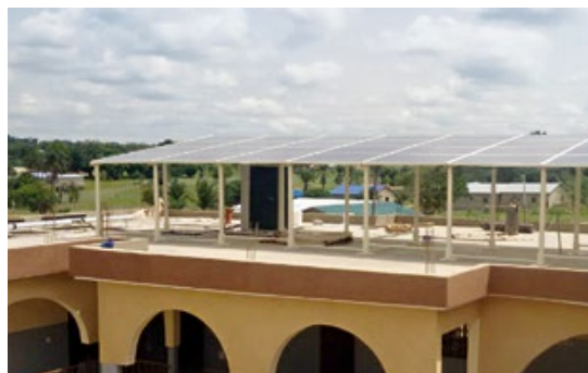
Das Kinderschutzzentrum CREUSET deckt seit 2019 einen Großteil seines Strombedarfs mit einer 10-kW Solarstromanlage auf dem Dach
