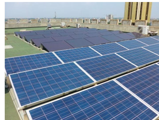
Erste netzgekoppelte Photovoltaik-Anlage in Togo: In Betrieb seit 2012 auf dem Dach des staatlichen Energieversorgers in Lome
