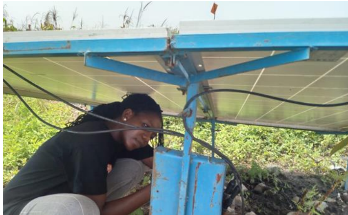
Taofidatou Tchabi ist Genderbeauftragte im URBIS Foundation Togo Team und gleichzeitig Solarexpertin. Hier untersucht sie den PV-Generator einer solaren Pumpanlage.
