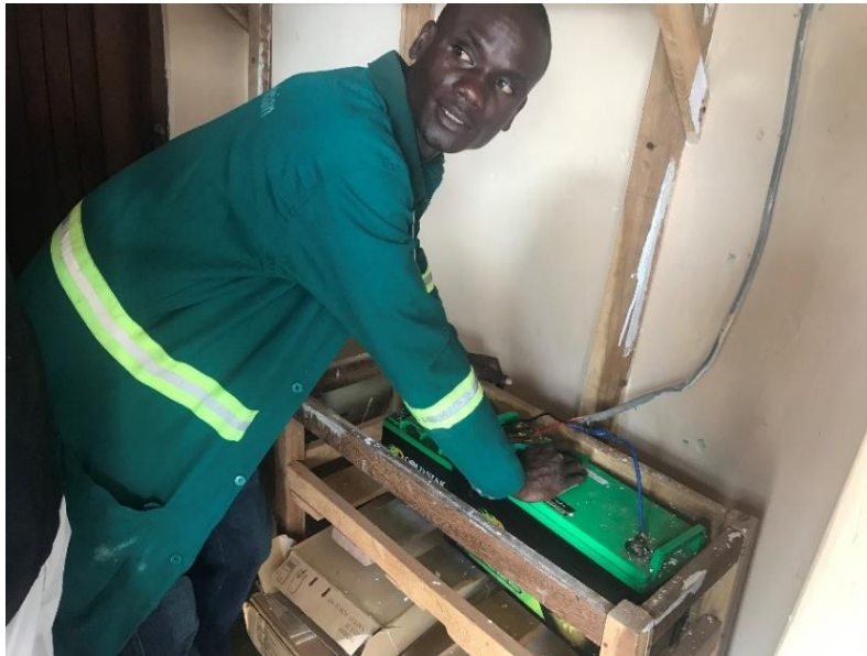
Ein Techniker untersucht die Funktionalität der neu-installierten PV-Anlage Copyright: ACCOD
