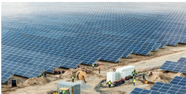
Chant de la centrale solaire de Blitta composé de modules polycristallins de capacité entre 300Wc et 390 Wc
