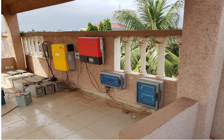
Bloc technique de la maison
