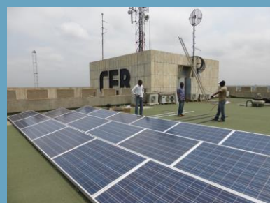
Sur le toit du siège de la CEB: la première installation PV connectée au réseau national mise en service en Août 2013
