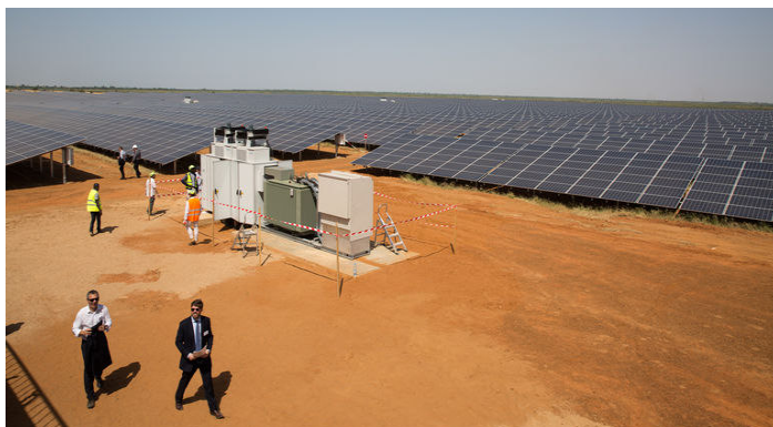
Champ de panneaux solaires
